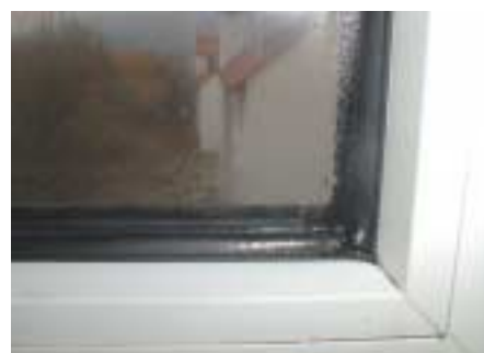
Abb. 3.3.4: Tauwasserbildung auf Verglasung.
