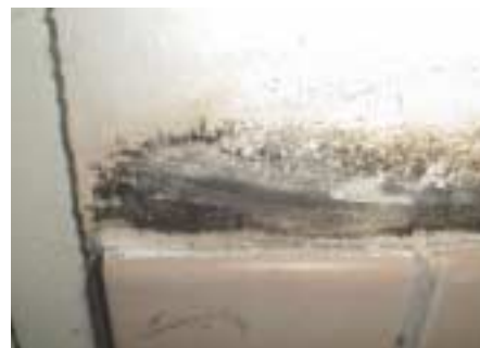
Abb. 3.3.5: Schimmelpilzbildung im Sockelbereich.
